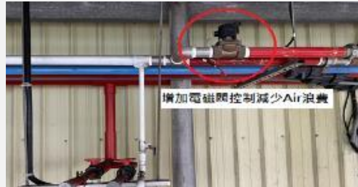
壓縮空氣使用有效管理
