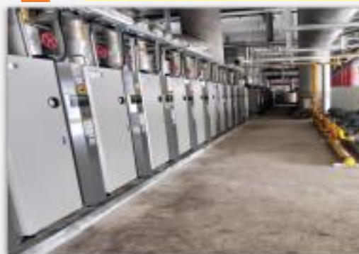
天然氣貫流式鍋爐(18台2.5噸)
